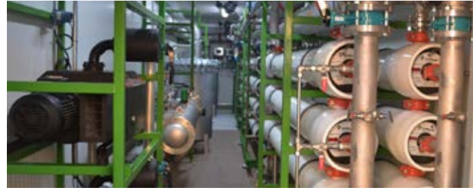
Resim 2: Membran Kontaktörlerinin ve Azot Pompalarının Saha Görüntüsü
